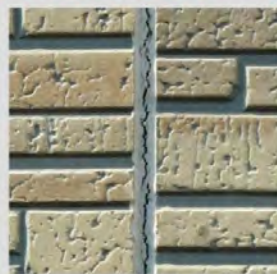
目地の白化と凝集破壊
