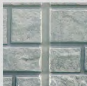
施工1~2年で発生する薄層はみ出し部の白化
